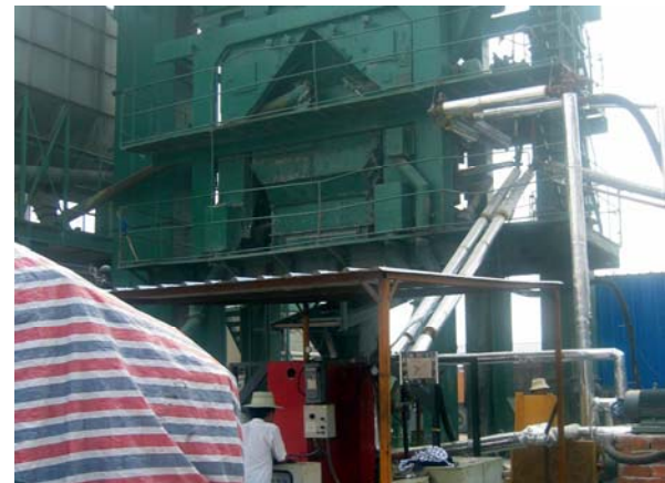
Trạm trộn BTN nóng với máy trộn BTN Êpôxy
